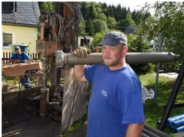
Die Firma Potscher aus Müglitz ließ von der Bobritzscher Firma Homilius einen Tiefbrunnen bohren, da der bisherige Brunnen ausgetrocknet ist, im Foto Mitarbeiter Matthias Zaharanski. Foto: Egbert Kamprath
