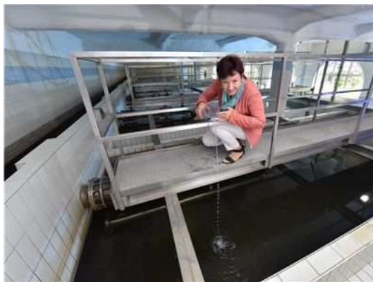
Die Filterhalle ist das Herzstück des Wasserwerks Klingenberg, sagt Inez Kritzner von der Wasserversorgung Weißeritzgruppe. Nach dem Filtern hat das Wasser aus der Talsperre Trinkwasserqualität.
