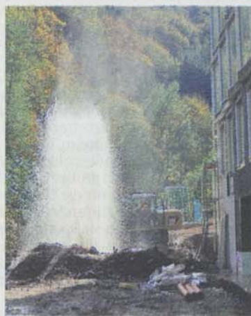
Bei Bauarbeiten hinter dem Lange-Manufakturneubau wurde die Hauptwasserleitung von Glashütte beschädigt. Eine meterhohe Fontäne stieg daraufhin aus der Erde, Foto: Weißeritzgruppe
